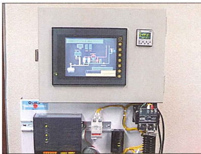
操作パネル展示モデル。ビルの設備機器を遠隔で24時間監視できると共に、電力の負荷も測定できる。
